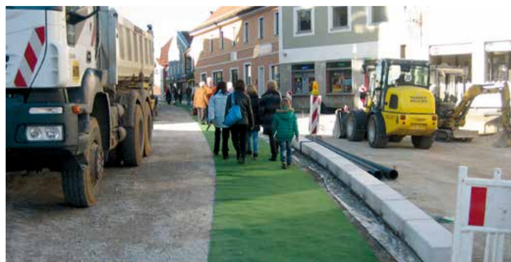
Ein grüner Teppich brachte die Menschen sauberen Fußes zu den Geschäften und Praxen. Positiver Nebeneffekt für die Bauarbeiter: Sie konnten ungehindert arbeiten, da jeder „in seinem Bereich“ blieb.
