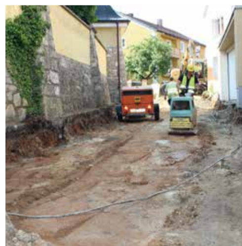
Auch in der Kirchengasse wurde hart gearbeitet und der alte Asphalt mühevoll abgetragen.
