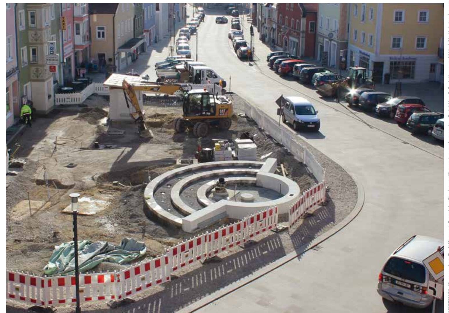
Die Bauarbeiten in der Zielgeraden: Der letzte Bauabschnitt mit eingebautem Infopavillon und vorbereiteter Brunnenanlage. Am 9. Mai zum Tag der Städtebauförderung wird der Schlussstein eingesetzt. Damit sind die Bauarbeiten abgeschlossen und im Juni wird die Einweihung des neuen Stadtplatzes gefeiert.
